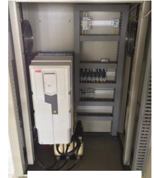
VSD ควบคุม PUMP
