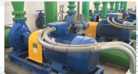
Pumps ขนาดใหญ่ ใช้ High Efficiency Motor
