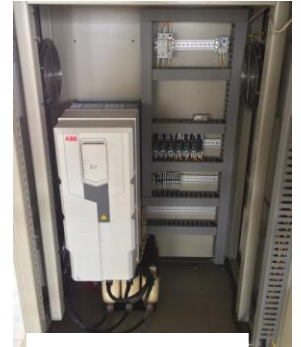
VSD ควบคุม PUMP
