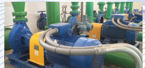
Pumps ขนาดใหญ่ ใช้ High Efficiency Motor
